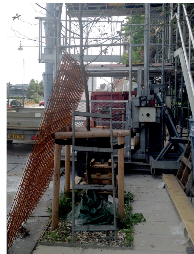
Figur 20: Foto viser et eksempel på, at der ikke holdes tilstrækkelig afstand til træet. Rionettet, som læner op ad stammen, vil skade træets bark og svække træets vækstvilkår. Der vises ikke hensyn til den investering, som netop er foretaget i etablering af træet.
